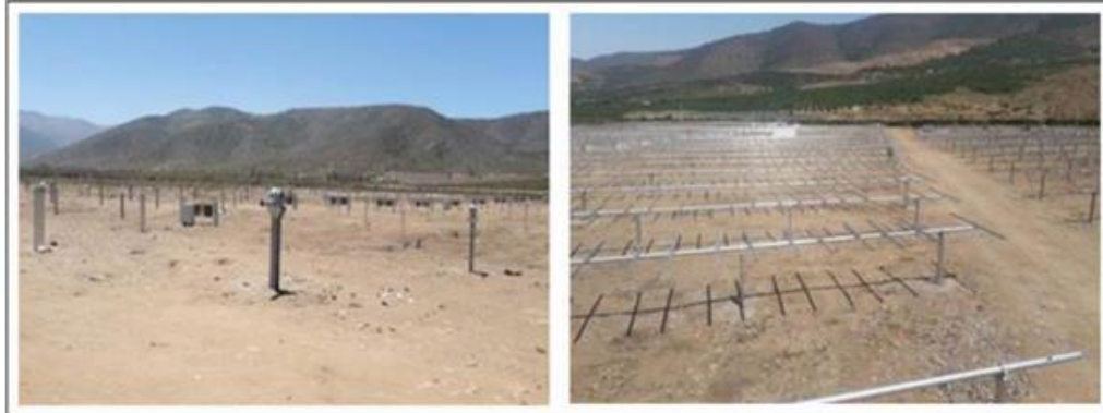
Figura 1-8. Pilares de Anclaje y Estructura de Soporte
